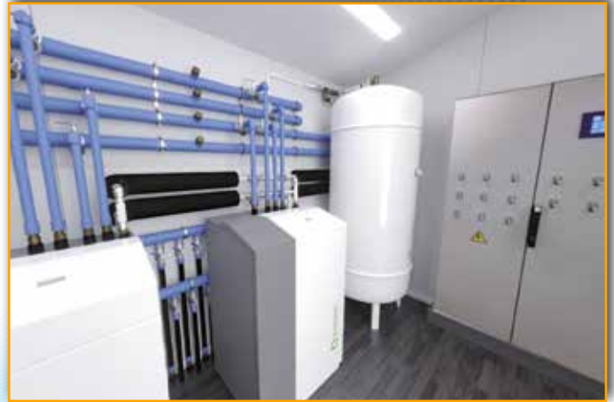
Technikraum (geothermischer Maschinenraum)
