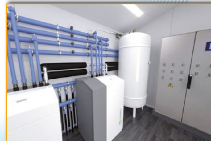
Technische ruimte (geothermische machinekamer)
