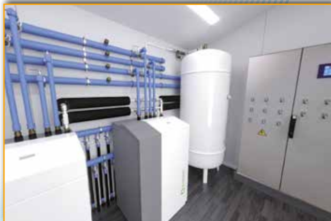
Interior caseta técnica (geotermia y tratamiento de agua)
