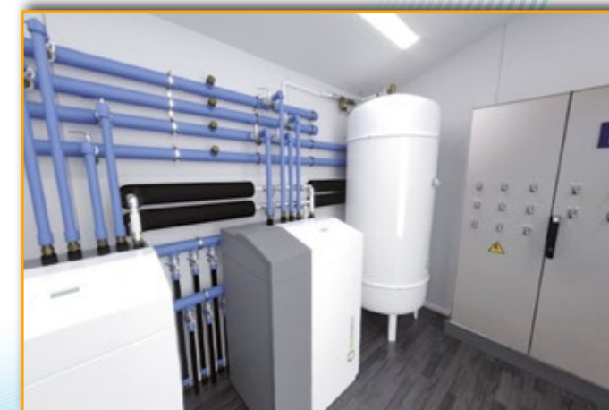
Salle technique (salle des machines géothermiques)
